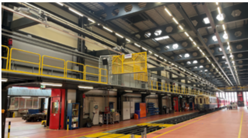
Bild oben: Abgesetzte Bedienstelle zur sicheren Steuerung der Fahrleitungsanlage mit den zugehörigen Elementen sowie dem Schlüsseldepot für den kontrollierten Zugang zu den Dacharbeitsbühnen und Gruben.
